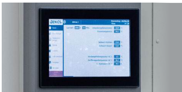
Surveillance et commande centralisées de tous les composants électriques avec la barre de communication
