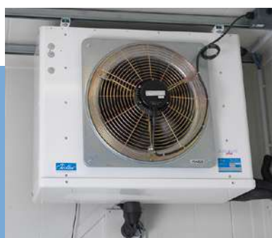
Climatisations split avec groupes frigorifiques (vue intérieure)
