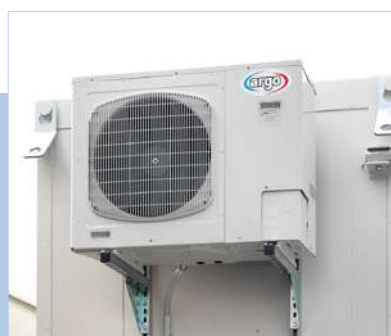
Climatisations split avec groupes frigorifiques (vue extérieure)
